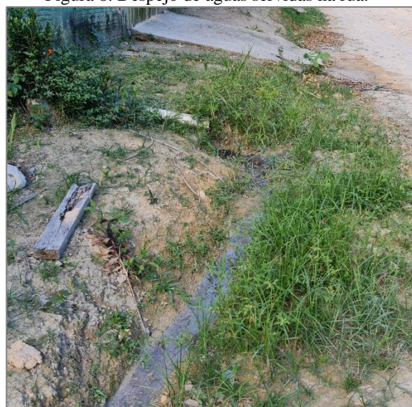
Figura 8. Despejo de águas servidas na rua.
