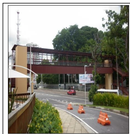
Figura 4 – Passarela coberta e acesso por escadas e elevador Fonte: Foto da autora, 2011.
